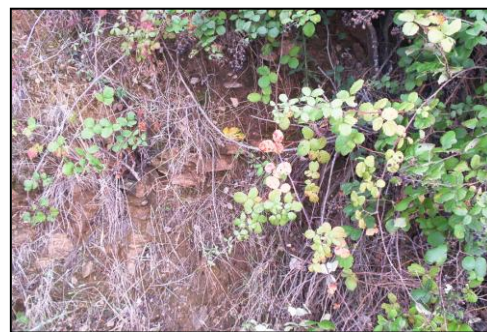
Foto 2. Possível entrada destruída da galeria a SE
