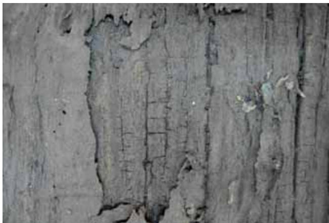
Fig. 20 — Pormenor do reverso do painel evidenciando corrosão de elementos metálicos sem função aparente.
