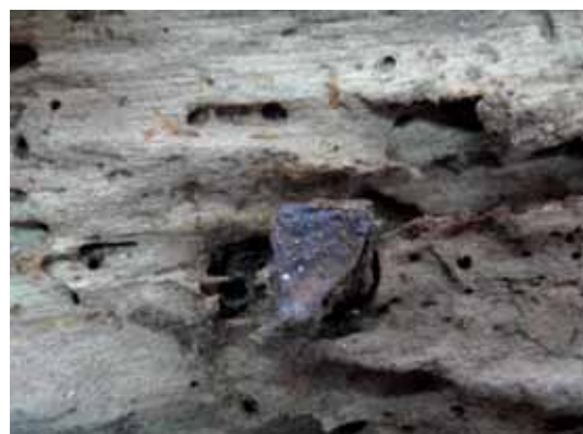
Fig. 19 — Pormenor do reverso do entablamento, evidenciando corrosão dos elementos metálicos.
