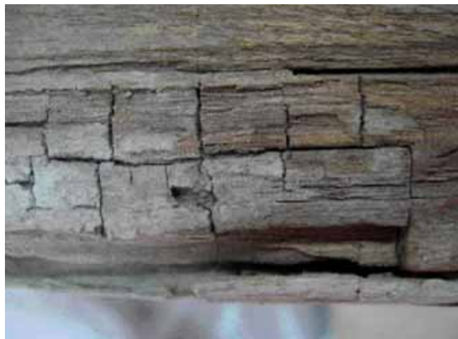
Fig. 13 — Pormenor do reverso do entablamento, evidenciando o ataque de fungos.
