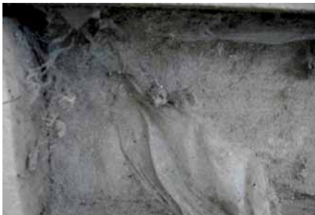
Fig. 23 — Pormenor do topo do entablamento, evidenciando acumulação de poeiras.
